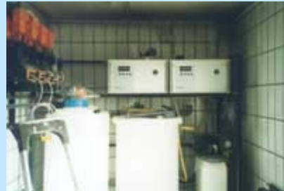
Immagine del complesso di trattamento per acqua potabile Enviolyte
