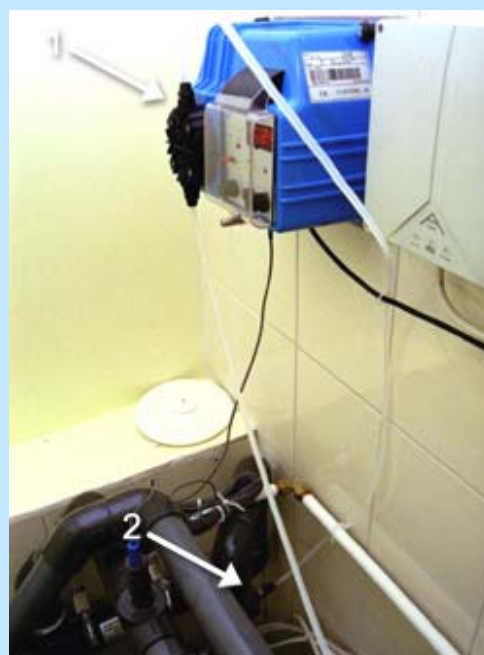
Il solo punto in cui EL-900 è collegato alle apparecchiature esistenti della piscina è il punto di dosaggio dell'anolyte
