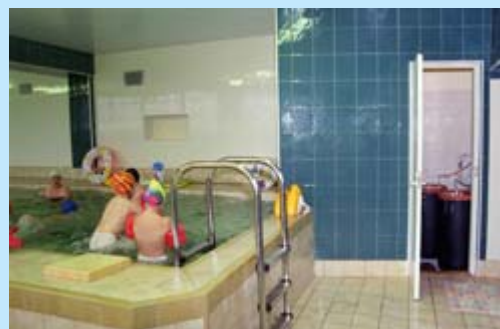
Vista complessiva dell'installazione della Enviolyte EL-900
