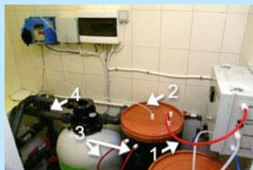
Locale operativo (circa 3 m 2 ) 1 – Uscita Anolyte 2 – Ingresso Anolyte 3 - Scarico 4 – Punto di dosaggio Anolyte
