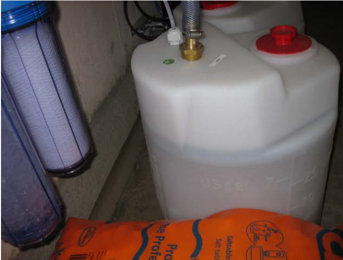
Serbatoio della salamoia
