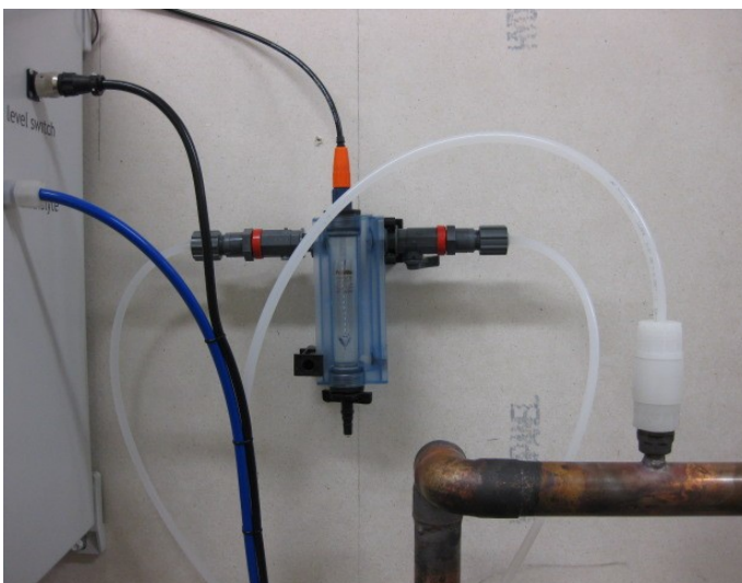
Sonda Redox e punto di iniezione
